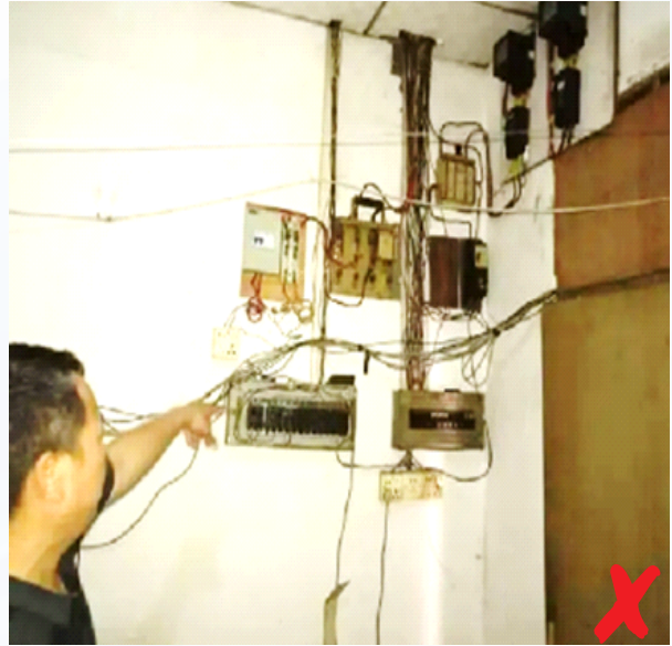
电气线路私拉乱接
