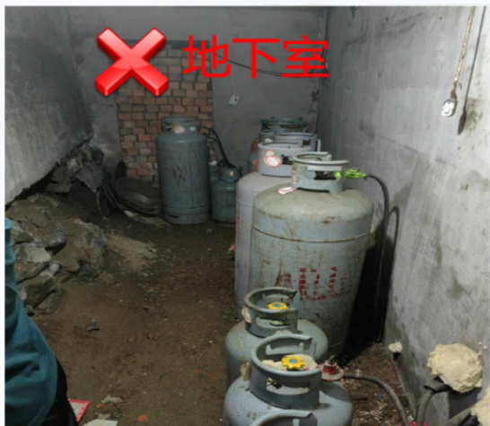
违规在地下室使用瓶装液化石油气
