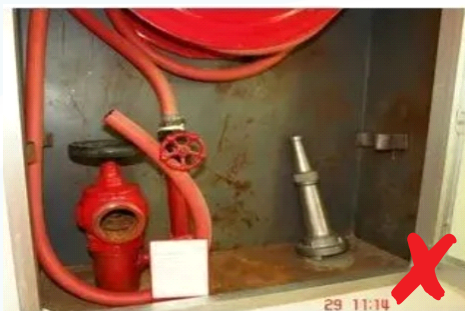
消火栓箱内配置不全
