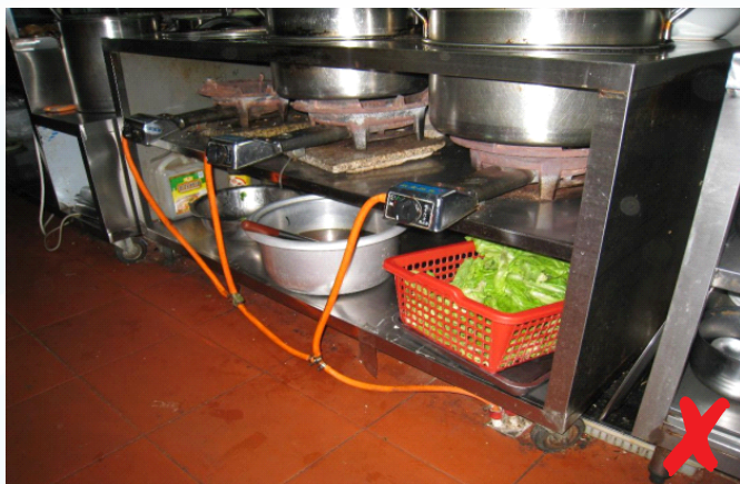
连接软管穿越地面，长度超过2米且有接头
