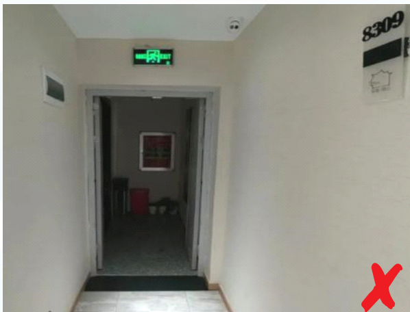
宾馆楼层只设置1个安全出口
