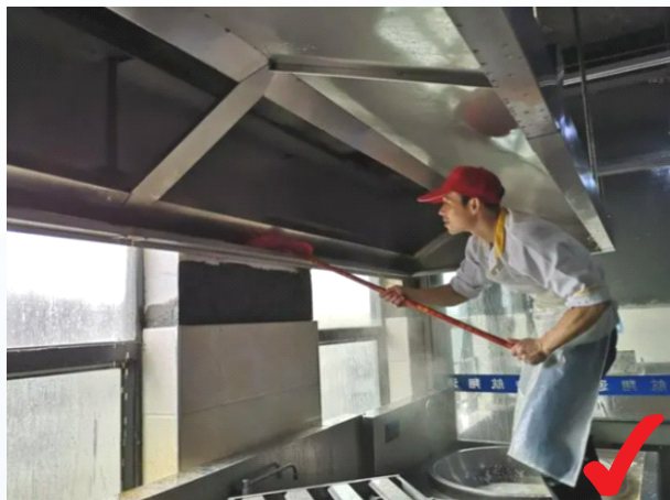
定期清洗油烟管道
