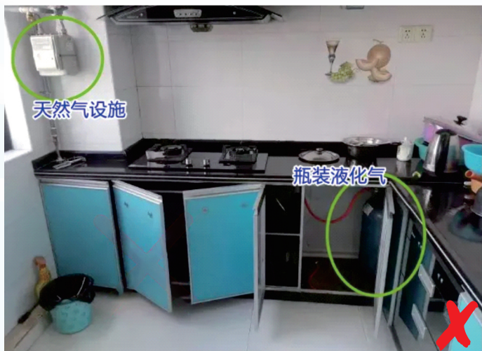
同一房间内违规使用两种燃料 (液化石油气和天然气)
