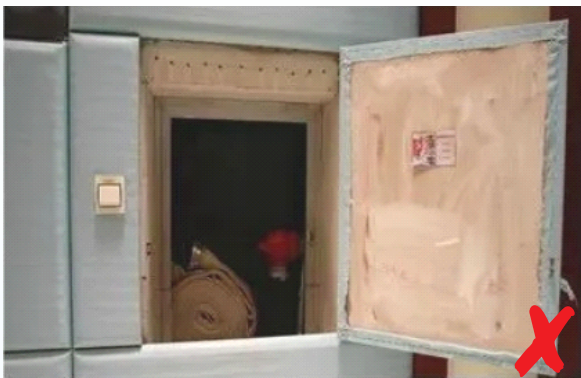
消火栓箱被封闭在装修材料内，没有明显标识
