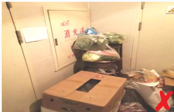
消火栓箱被遮挡，不方便使用
