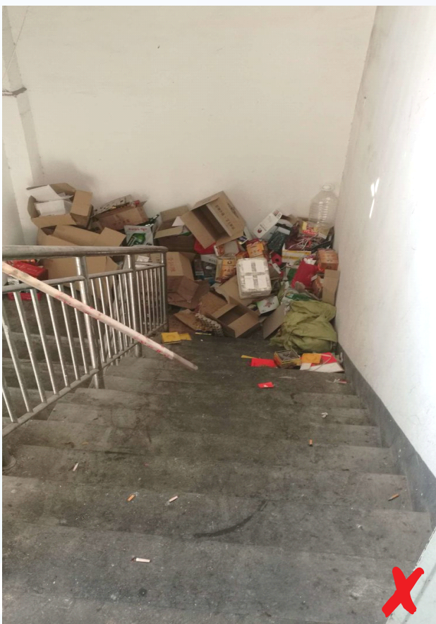
疏散通道堆满杂物
