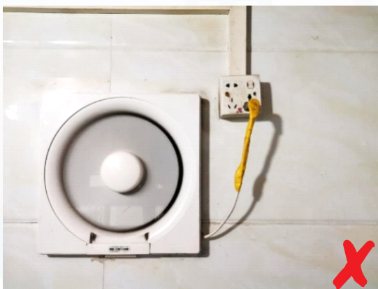
电器插头被更换，不接地
