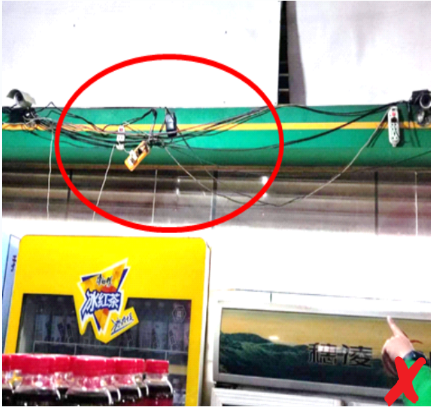
电气线路私拉乱接
