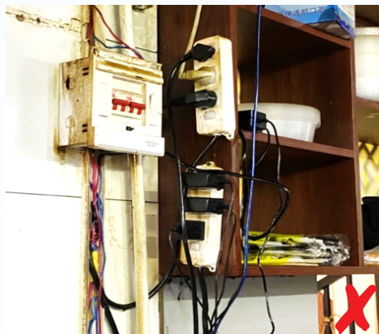
低于1.8m垂直敷设的电气线路未套管私拉乱接
